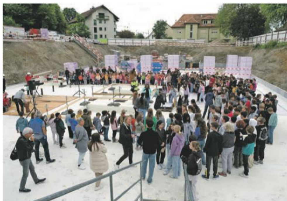
In der Baugrube des neu zu bauenden Schulhauses Zentrum fand die Grundsteinlegung mit 330 Kindern und ihren Lehrkräften sowie weiteren Verantwortlichen statt.
